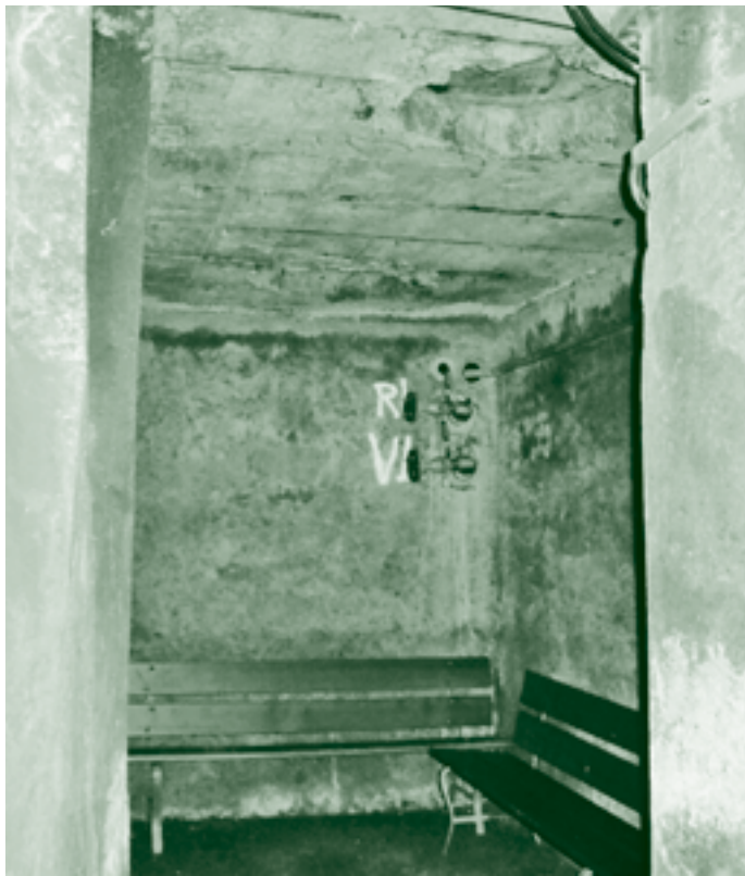
Ehemaliger Kohlenkeller/neue Anschlüsse Fernwärme
