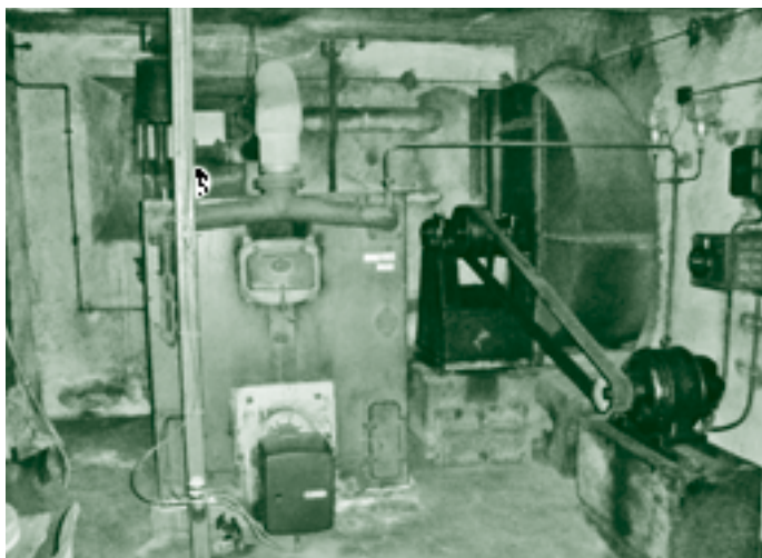
Heizraum mit altem Heizkessel und Ölbrenner
